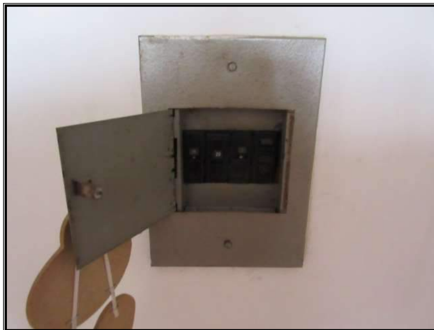
Foto nº 11 – Vista do quadro de disjuntores das instalações elétricas.
