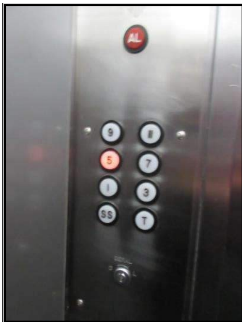
Foto nº 07 – Vista parcial identificação dos andares do elevador que serve os andares ímpares.
