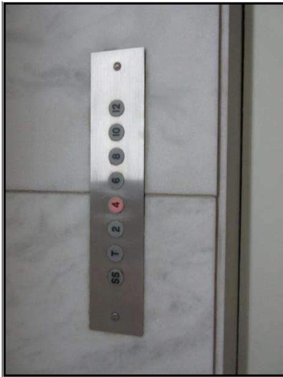
Foto nº 17 – Vista do quadro de chamada do elevador.
